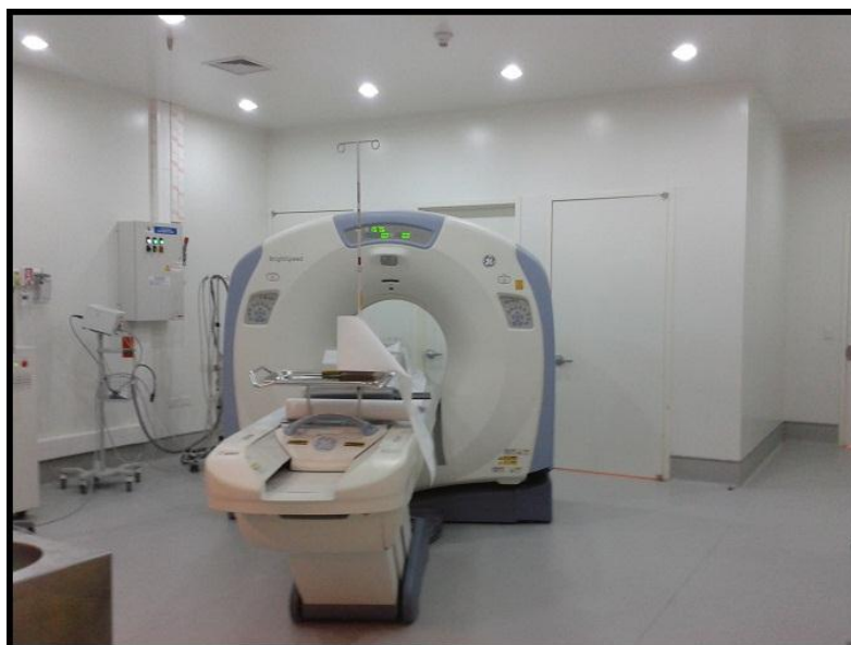
Figura N° 1. Sala de Scanner (I 1-2) área Imagenología. Hospital La Florida.
